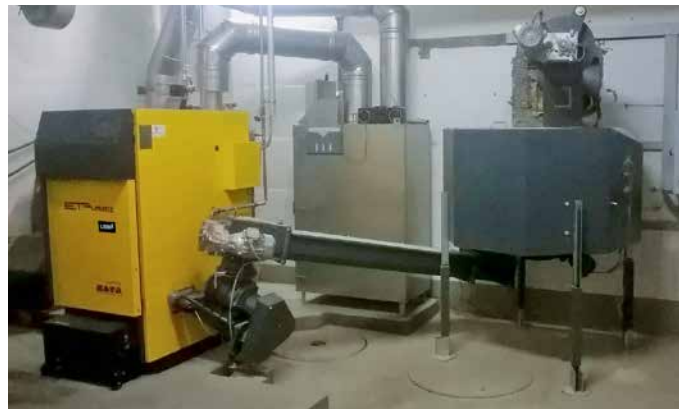
Ein Zwischenbehälter mit Lichtschranke (ganz rechts) puffert die Hackschnitzelzufuhr von der Austragungsschnecke zum Heizkessel (links).
