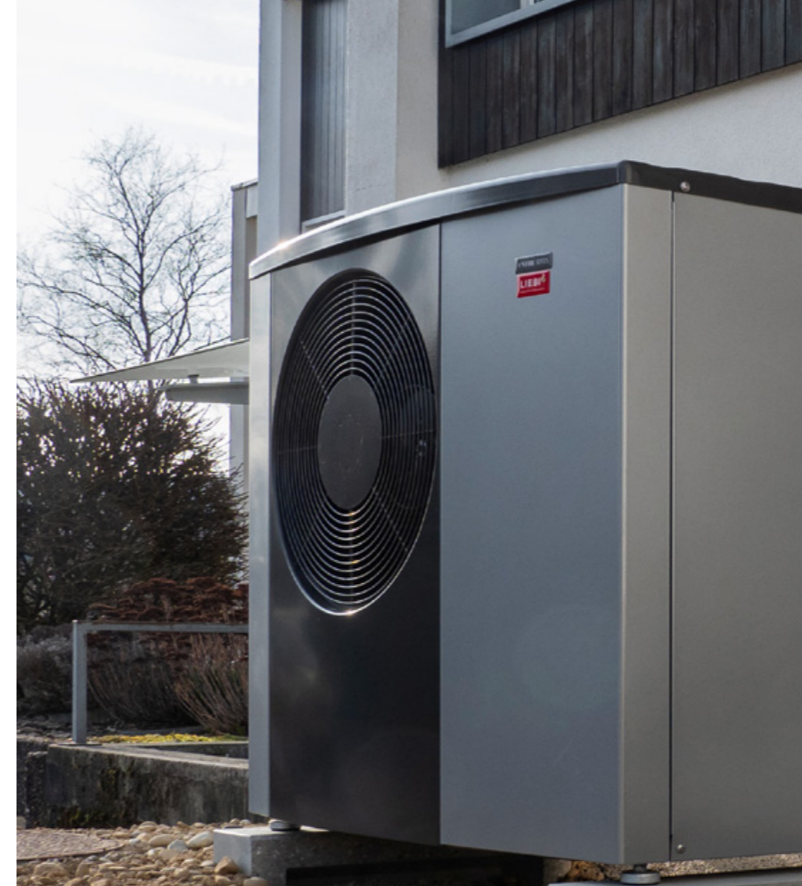
Beim richtigen Umgang mit Propan kann das Kältemittel bedenkenlos eingesetzt werden.
