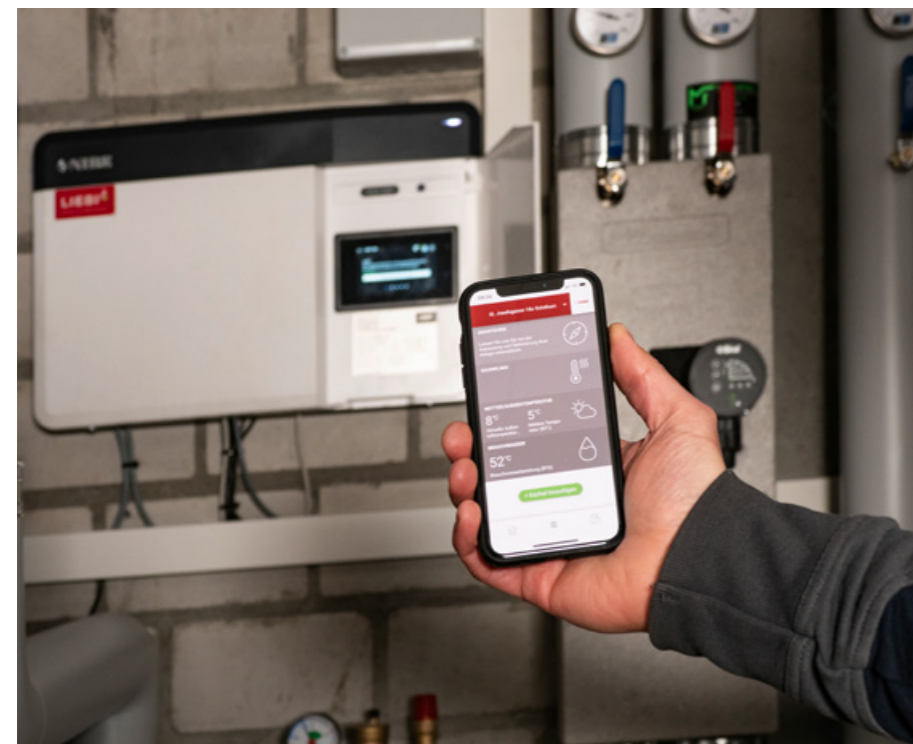
Auch Steuerung und Kontrolle per App sind smart.
